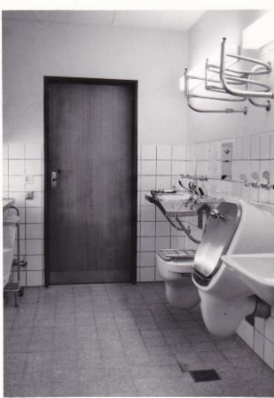
Billede 11: Decentraliseret skyllerum
